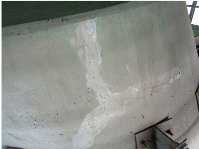
교각 운동장방향 P3 전면 균열
