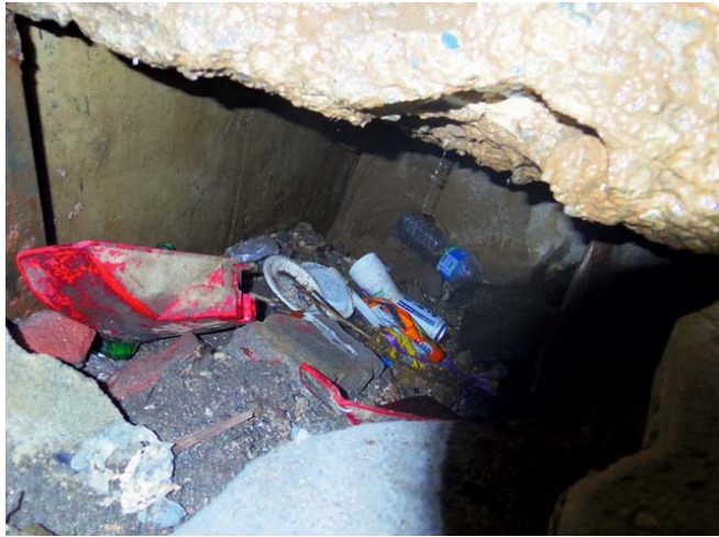
교대 포스코방향 A1 법면 공동
