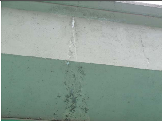
슬래브하면 포스코방향 S06 캔틸레버 균열부 백태
