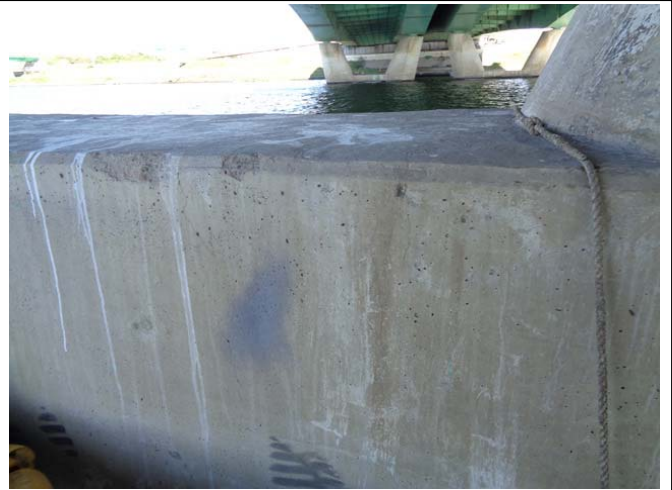
교각 운동장방향 P2 기둥부 균열
