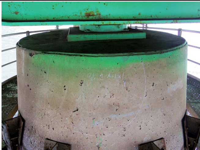
교각 포스코방향 P4 정면 망상균열
