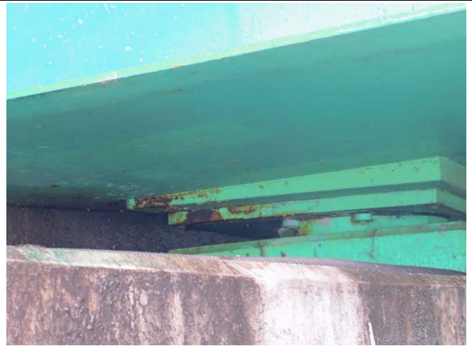
교량받침 포스코방향 A1-SH2 받침콘크리트 균열 및 도장손상
