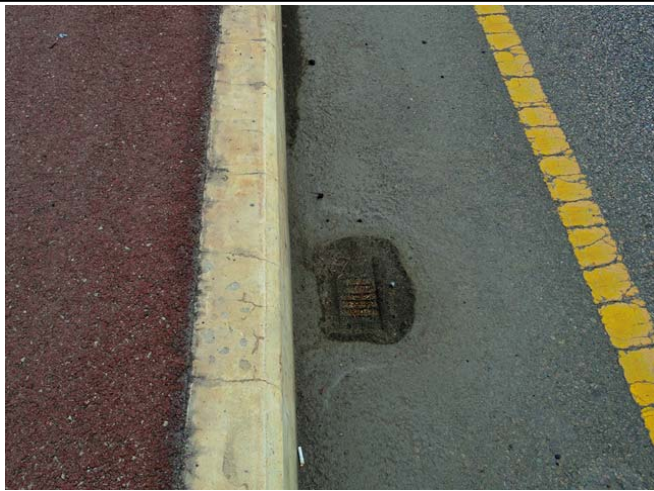
배수시설 운동장방향 S04 배수구 막힘
