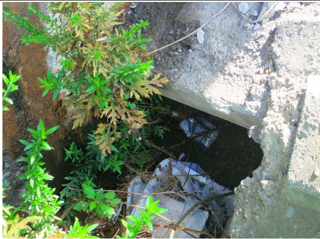
교대 포스코방향 A2 날개벽 블럭 침하 및 파손
