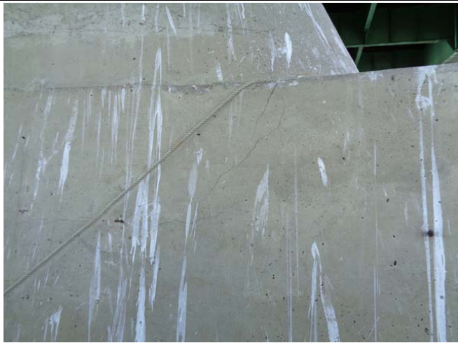
교각 운동장방향 P3 기둥부 균열
