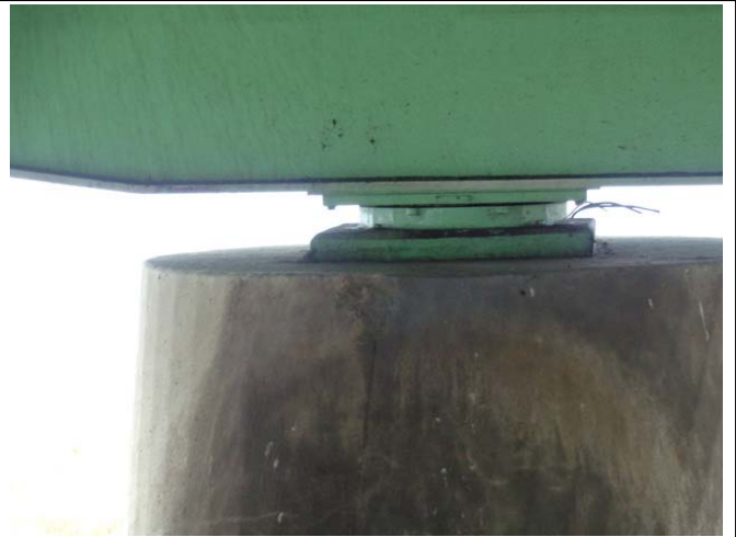
교각 포스코방향 P7 기둥부 파손
