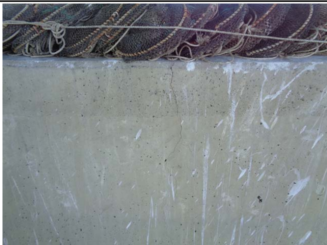
교각 운동장방향 P3 기둥부 균열
