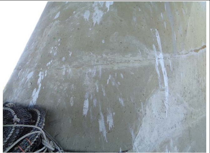
교각 운동장방향 P3 기둥부 균열
