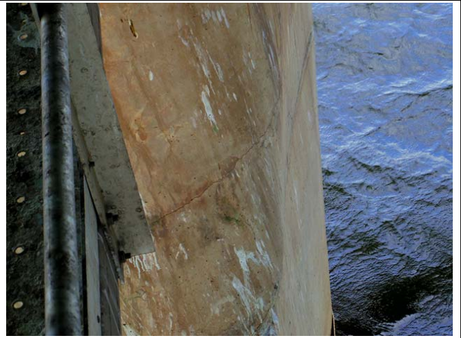
교각 포스코방향 P3 배면 균열
