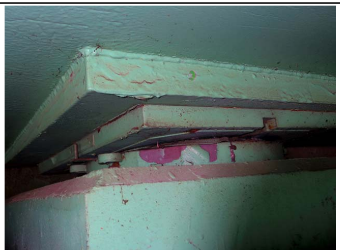
교량받침 포스코방향 A1-SH1 도장손상
