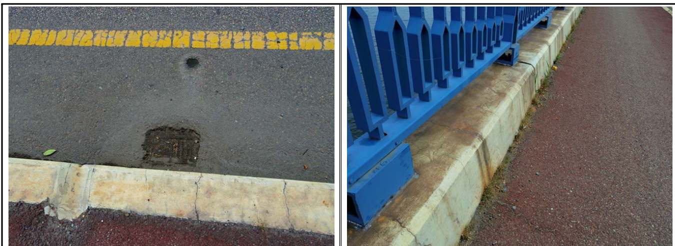
연석 운동장방향 S03 도로부 수직균열
