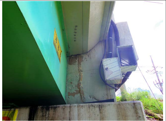
교대 포스코방향 A2 백태
