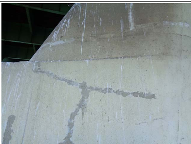
교각 운동장방향 P5 기둥부 균열
