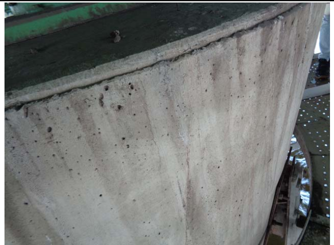
교각 포스코방향 P05 균열
