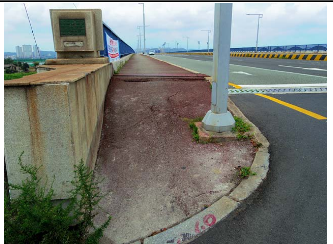
연석 포스코방향 S10 보도부 침하 A=2.5m×5.0m
