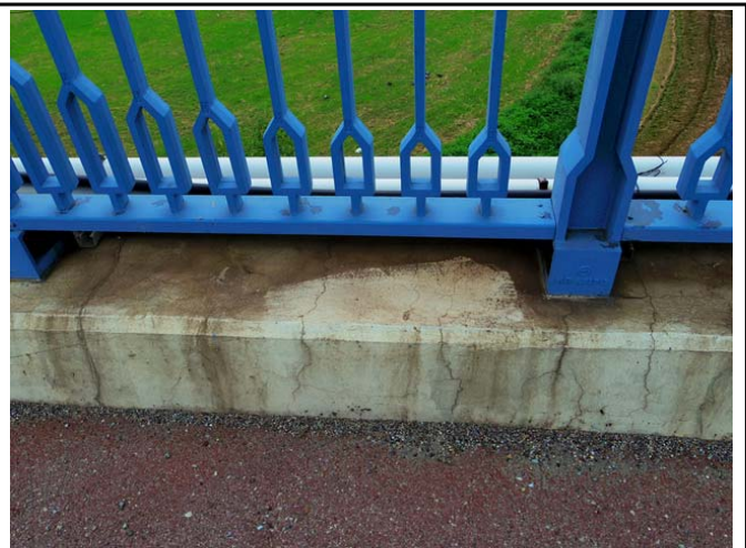
연석 포스코방향 S09 외측 균열
