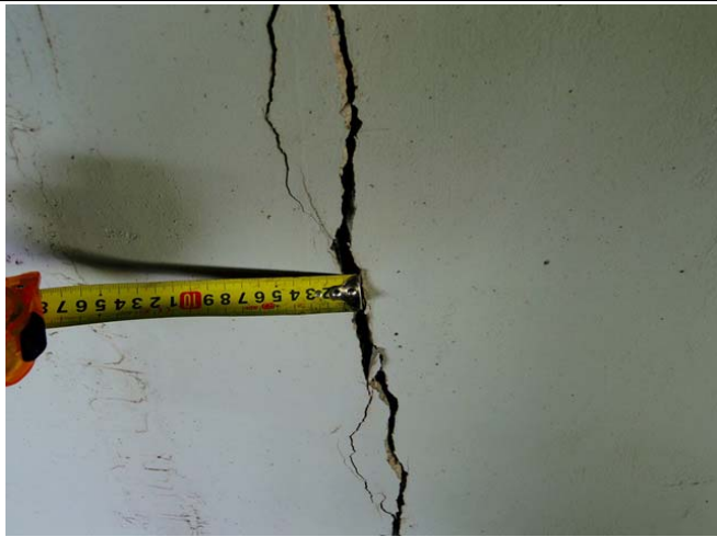
교대 운동장방향 A2 균열
