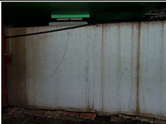
교대 A1 운동장방향 균열
