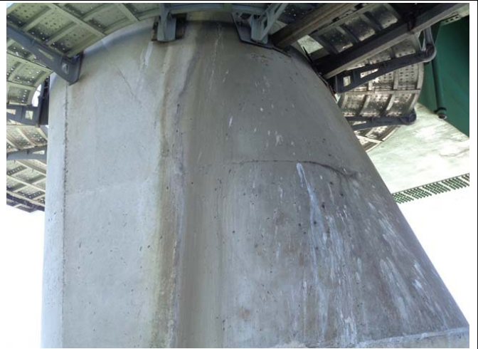
교각 포스코방향 P4 기둥부 균열
