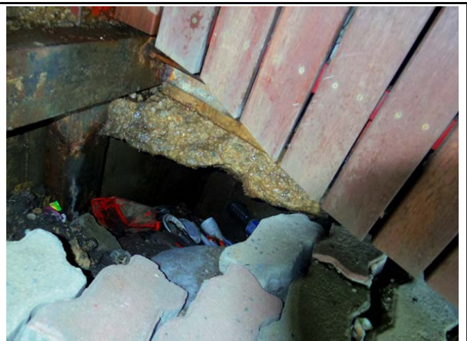
교대 포스코방향 A1 법면 공동
