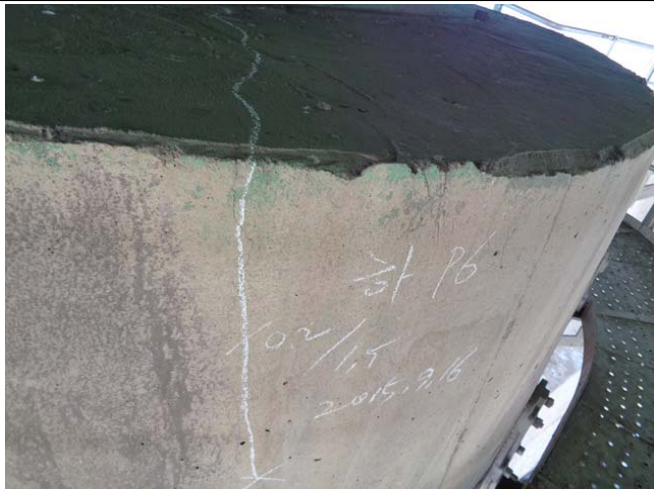
교각 운동장방향 P6 균열
