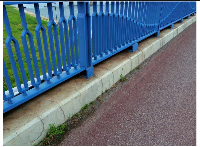
연석 포스코방향 S07 외측 균열
