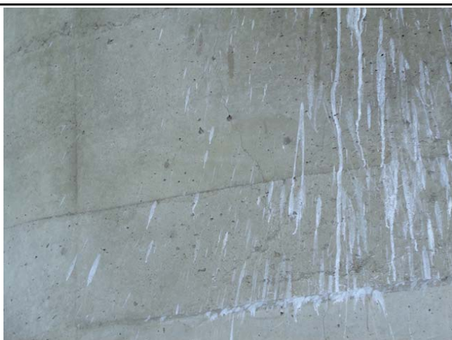
교각 운동장방향 P4 기둥부 균열
