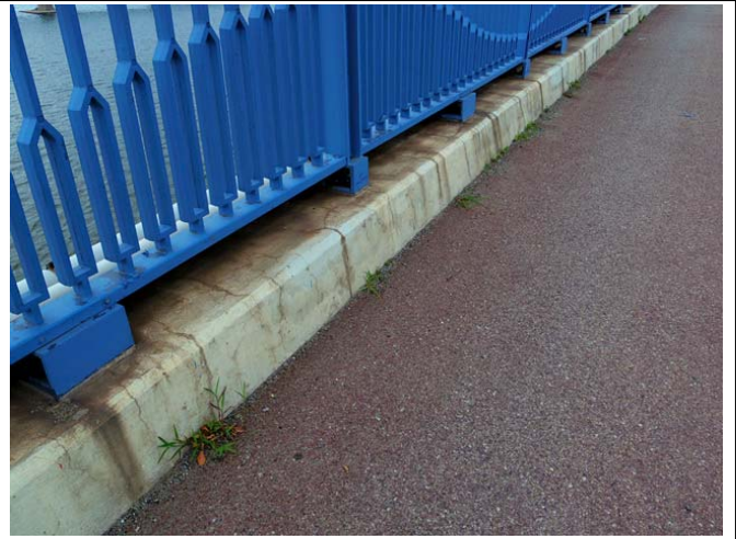
연석 포스코방향 S05 외측 균열
