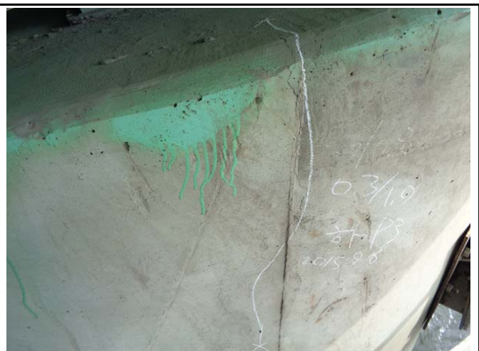
교각 운동장방향 P3 전면 균열
