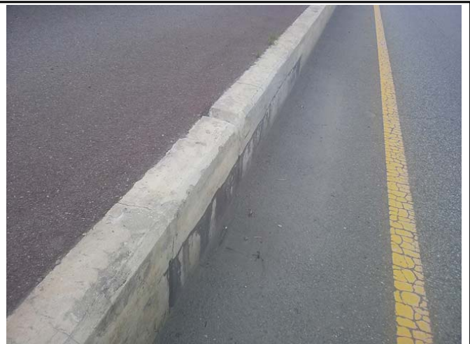
연석 포스코방향 S03 도로부 균열
