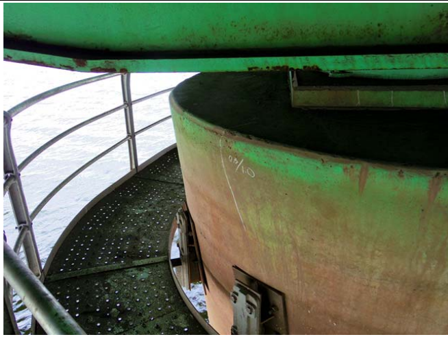
교각 포스코방향 P4 정면 균열
