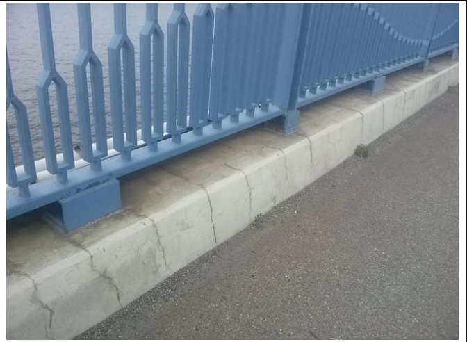
연석 포스코방향 S02 외측 균열
