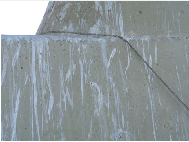
교각 운동장방향 P4 기둥부 균열
