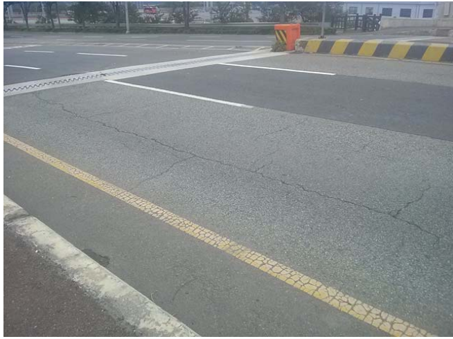
교면포장 포스코방향 S01 3차선 망상균열
