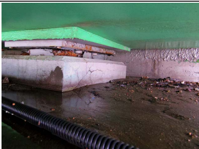
교량받침 운동장방향 A1-SH1 도장손상 및 받침콘크리트 균열
