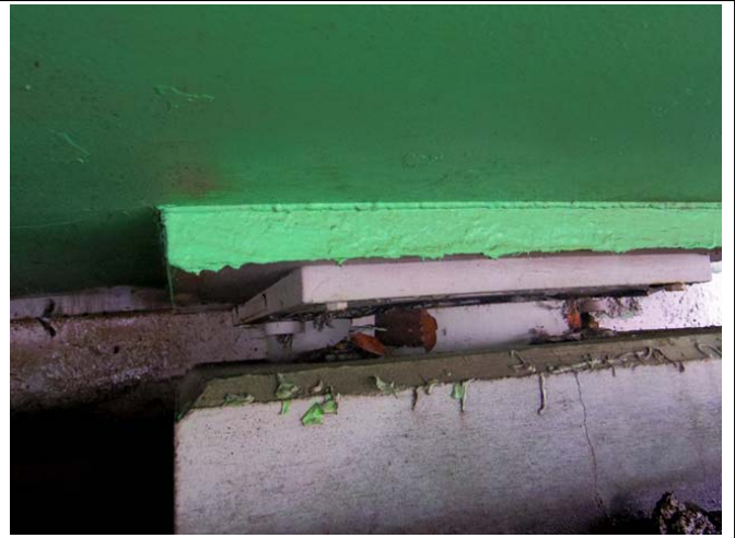
교량받침 운동장방향 A1-SH1 도장손상 및 받침콘크리트 균열
