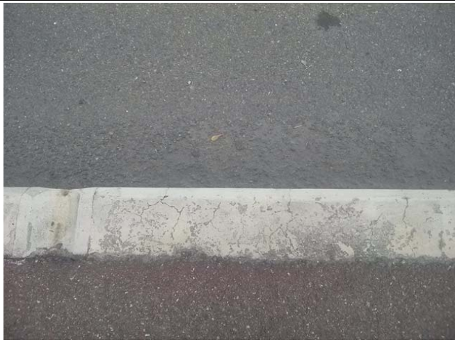
연석 포스코방향 S02 도로부 균열
