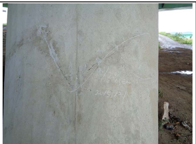
교각 포스코방향 P8 기둥부 균열
