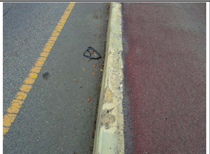
연석 운동장방향 S10 도로부 탈락
