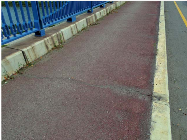
연석 운동장방향 S09 보도부 균열
