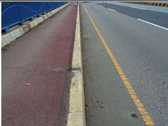
연석 운동장방향 S10 도로부 수직균열
