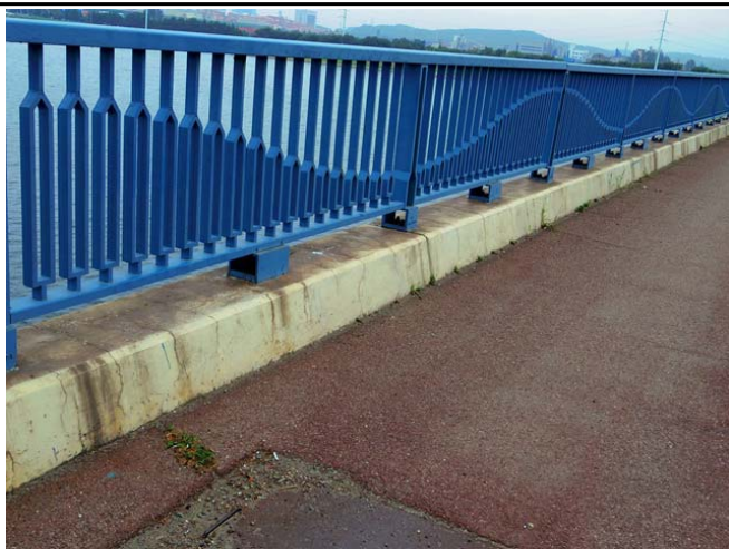
연석 운동장방향 S04 외측 균열
