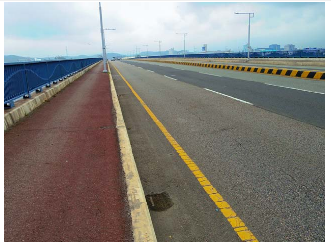
배수시설 운동장방향 S02 배수구 막힘
