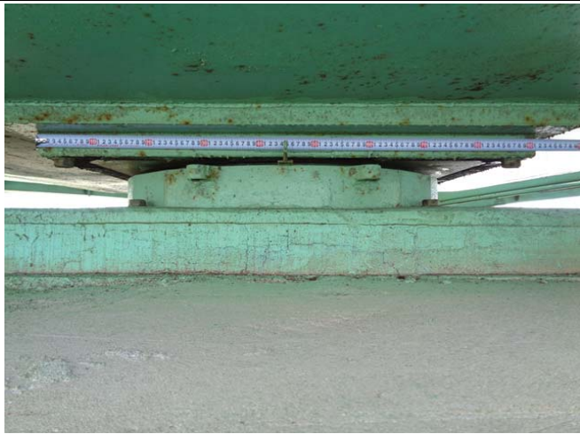
교량받침 P6-SH1 -10 받침콘크리트 균열1
