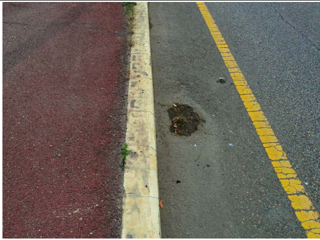
배수시설 운동장방향 S01 배수구 막힘
