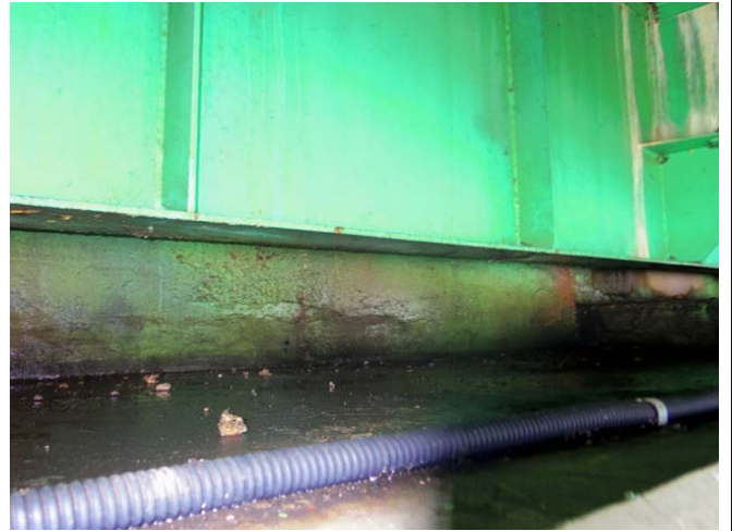
교대 포스코방향 A1 이물질퇴적
