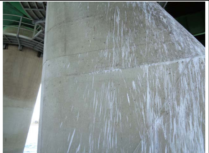
교각 운동장방향 P4 기둥부 균열
