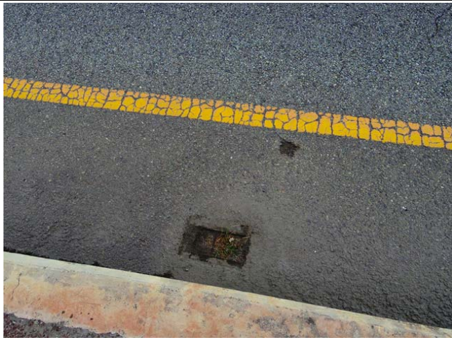
배수시설 포스코방향 S07 배수구 막힘
