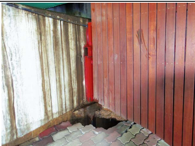
교대 포스코방향 A1 법면 공동
