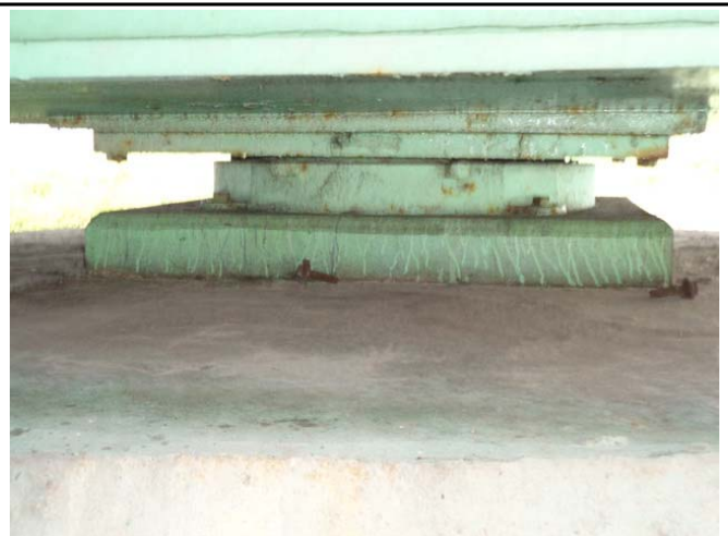
교량받침 운동장방향 P8-SH2 받침콘크리트 균열
