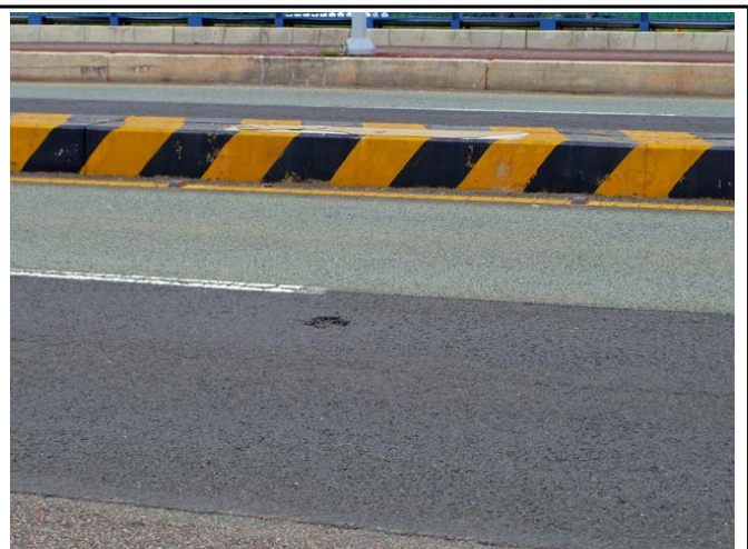
교면포장 운동장방향 S06 포트홀
