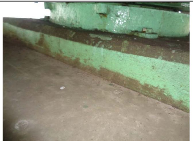
교량받침 운동장방향 P7-SH2 받침콘크리트 균열
