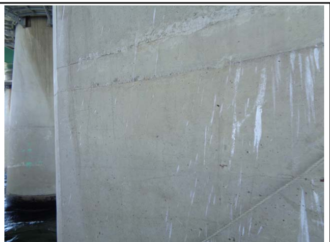
교각 운동장방향 P3 기둥부 균열
