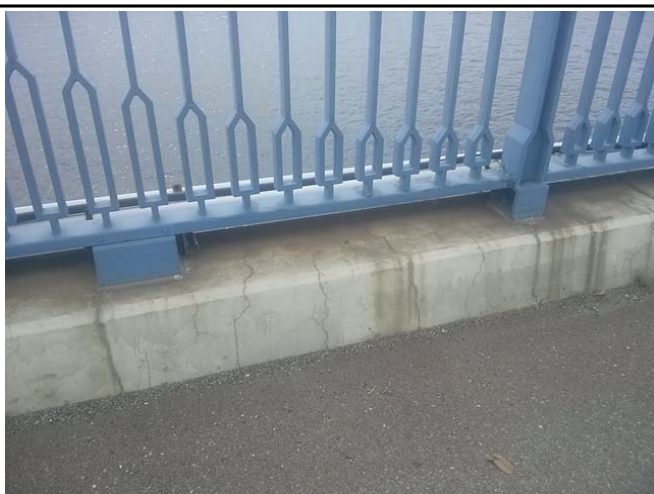
연석 포스코방향 S03 외측 균열
