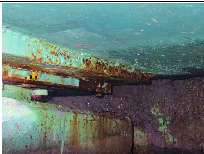
교량받침 포스코방향 A1-SH2 받침콘크리트 균열 및 도장손상
