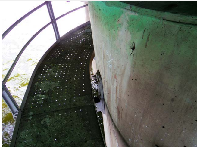
교각 포스코방향 P3 배면 균열
