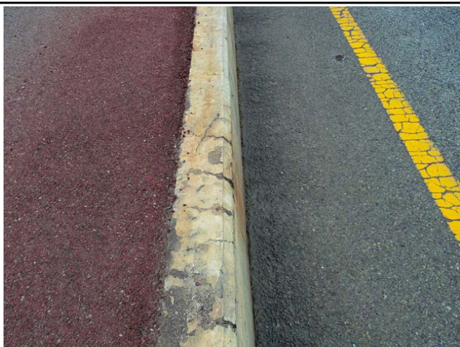
연석 포스코방향 S09 도로부 균열
