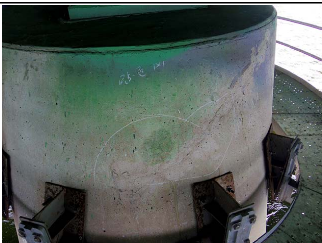
교각 포스코방향 P3 정면 망상균열
