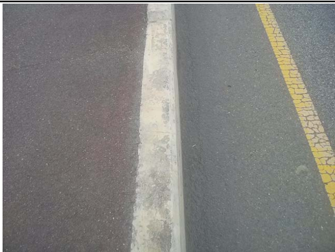
연석 포스코방향 S03 도로부 균열
