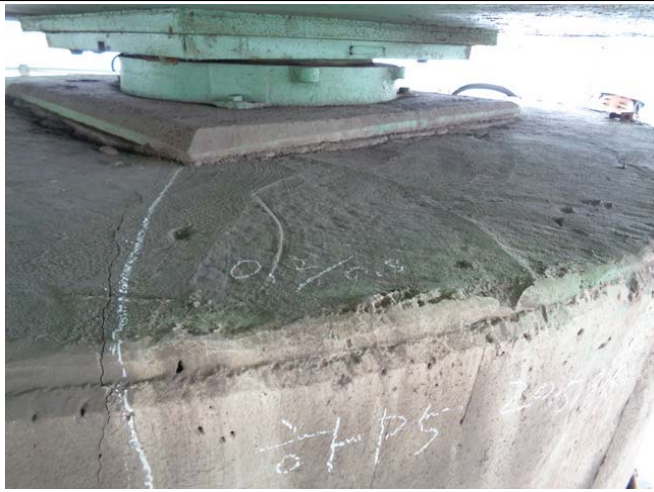
교각 운동장방향 P5 균열
