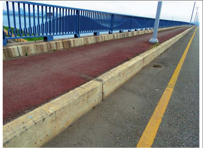
연석 운동장방향 S01 도로부 수직균열
