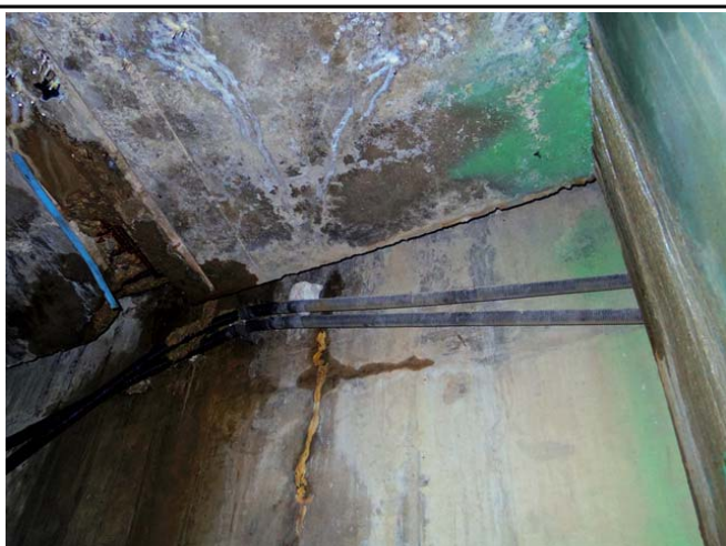
교량받침 운동장방향 A1-SH2 배면 슬래브 파손 및 하부 퇴적
