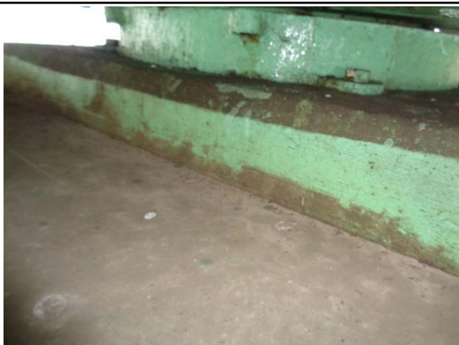
교량받침 운동장방향 P7-SH2 받침콘크리트 균열
