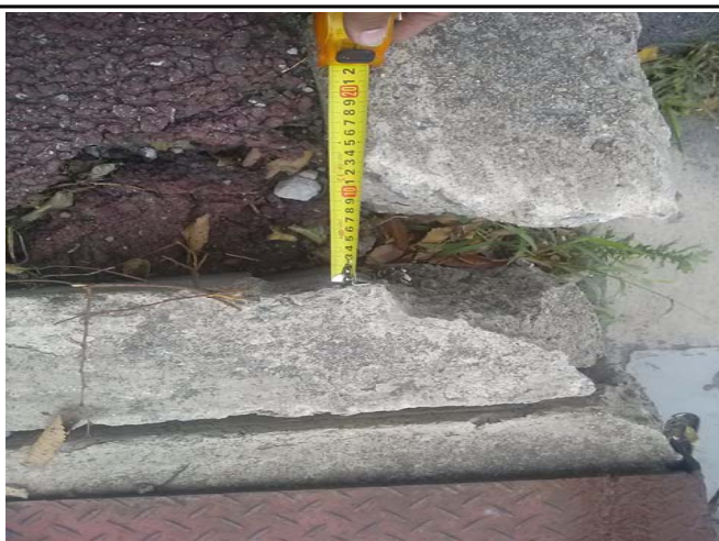
연석 포스코방향 S01 보도부 침하 A=2m×1m
