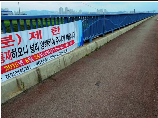
연석 포스코방향 S10 외측 균열
