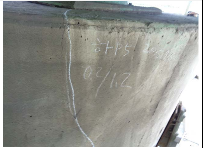
교각 운동장방향 P5 균열
