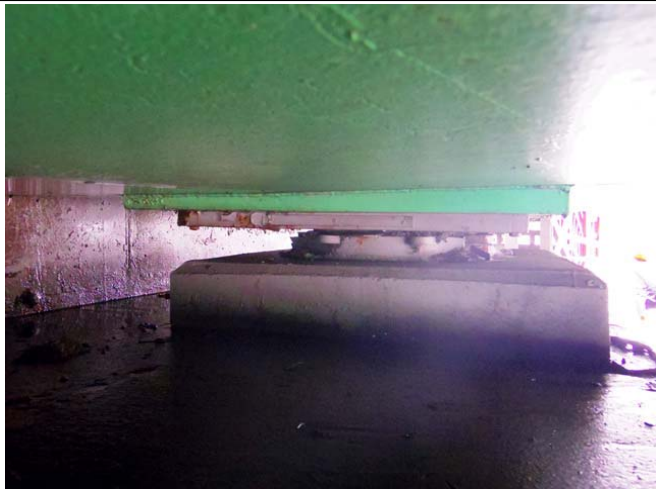
교량받침 운동장방향 A1-SH1 도장손상 및 받침콘크리트 균열
