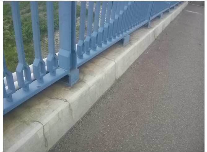
연석 포스코방향 S01 외측 망상균열
