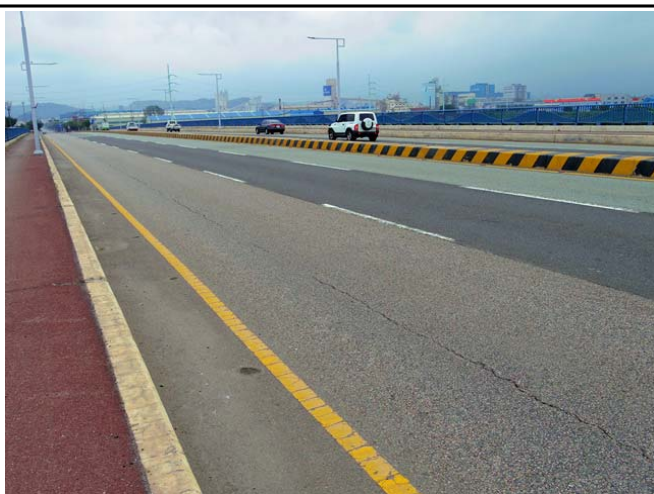
교면포장 운동장방향 S06 3차로 전구간 균열 및 라벨링
