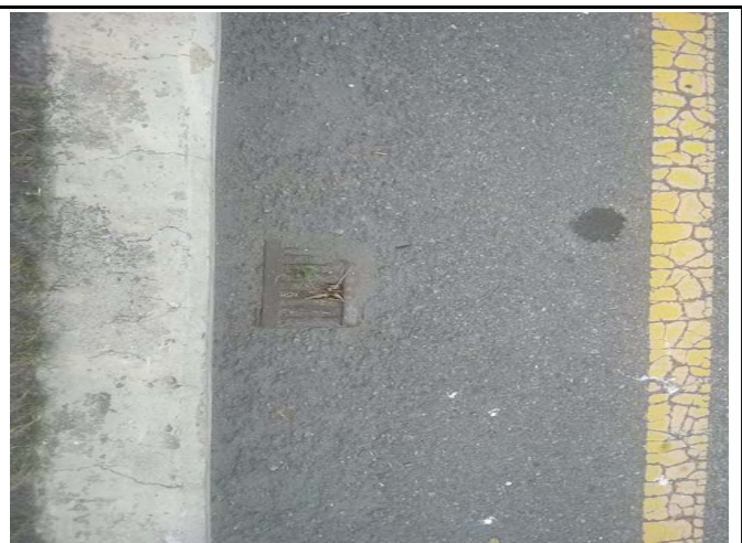
배수시설 포스코방향 S02 배수구 막힘
