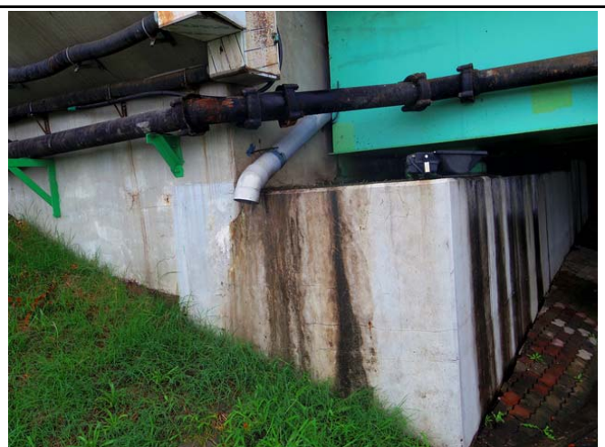
교대 포스코방향 A1 날개벽 망상균열
