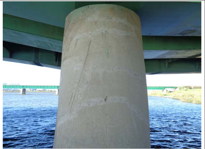
교각 포스코방향 P1 기둥부 균열
