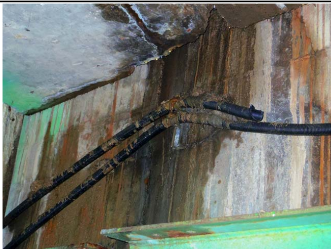
슬래브하면 A2 중앙부 파손 및 하부 이물질퇴적
