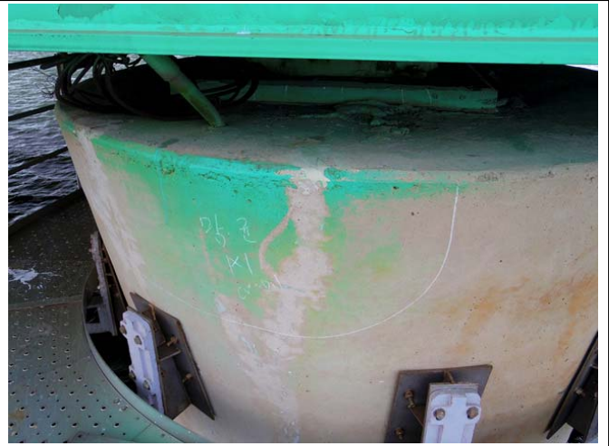
교각 포스코방향 P4 정면 망상균열
