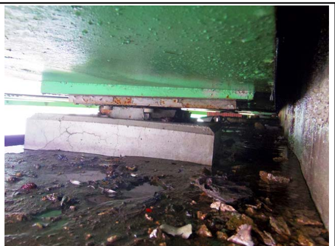
교량받침 운동장방향 A1-SH1 도장손상 및 받침콘크리트 균열
