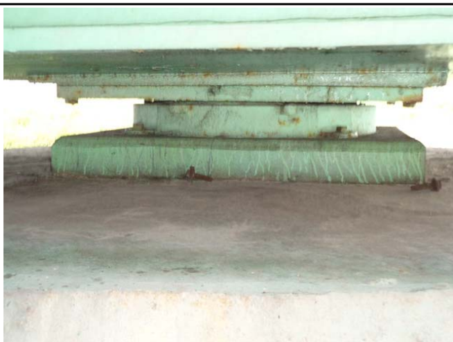
교량받침 운동장방향 P8-SH2 받침콘크리트 균열
