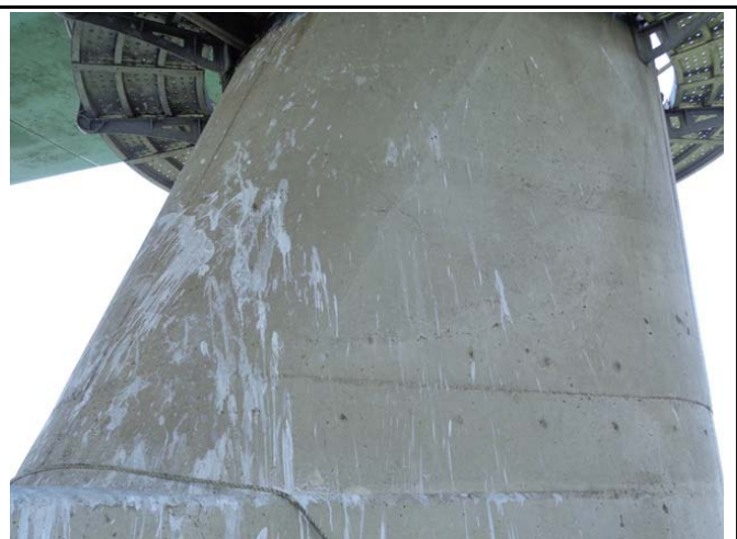
교각 운동장방향 P4 기둥부 균열
