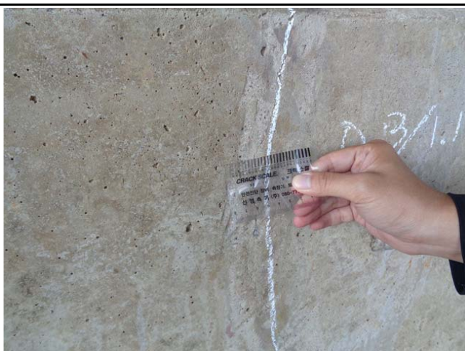
교각 P7 균열
