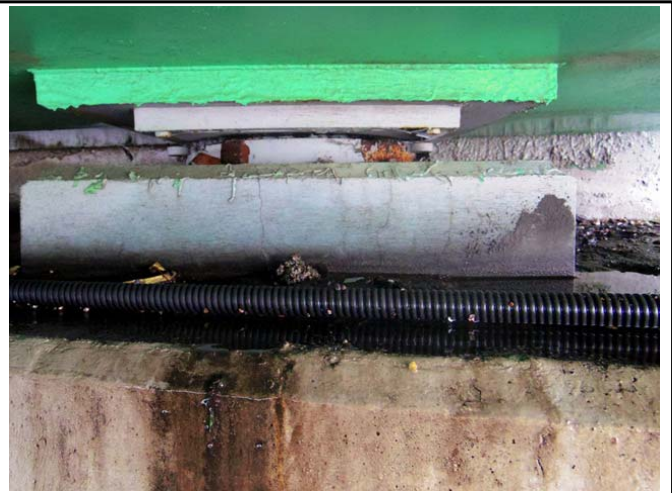
교량받침 운동장방향 A1-SH1 도장손상 및 받침콘크리트 균열
