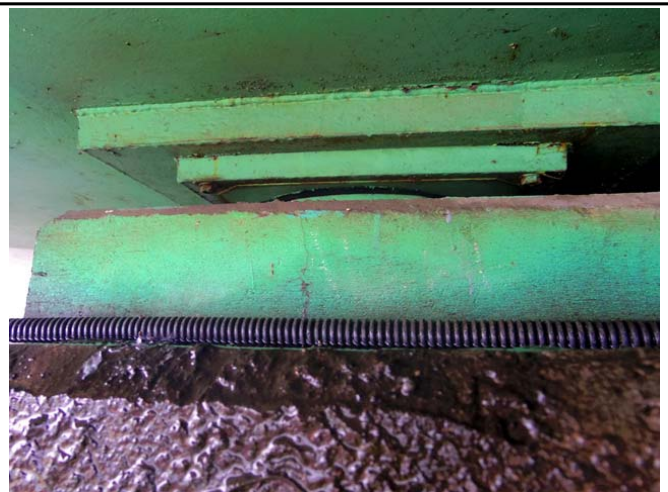
교량받침 포스코방향 A1-SH2 받침콘크리트 균열 및 도장손상
