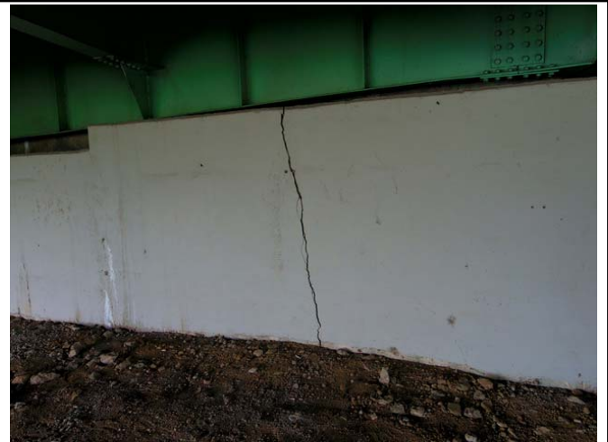
교대 운동장방향 A2 균열
