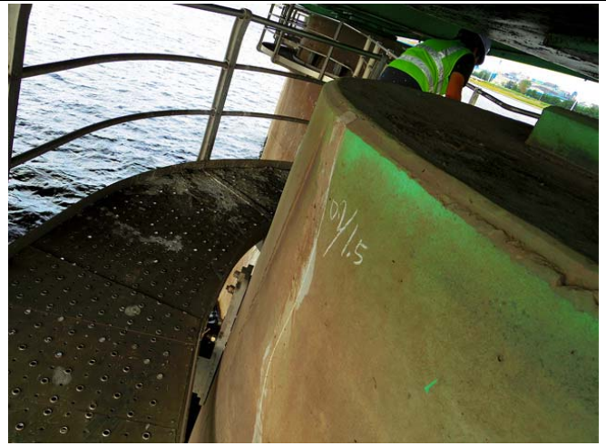
교각 운동장방향 P4 배면 균열
