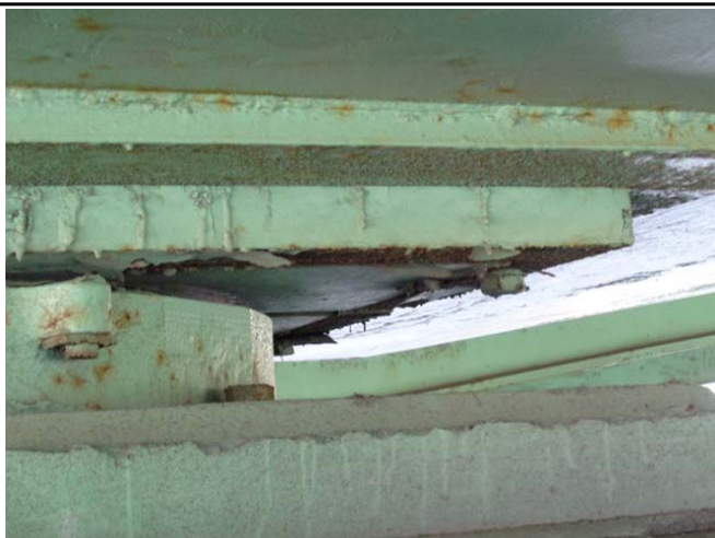
교량받침 포스코방향 P2-SH2 부식
