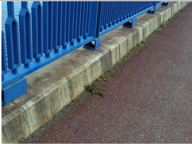
연석 운동장방향 S01 외측 균열
