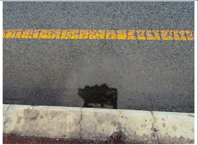
배수시설 포스코방향 S09 배수관 막힘
