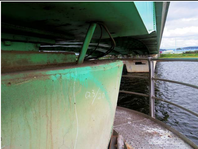
교각 운동장방향 P4 하류측면 균열
