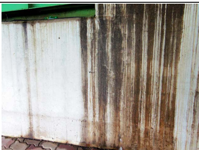
교대 포스코방향 A1 균열
