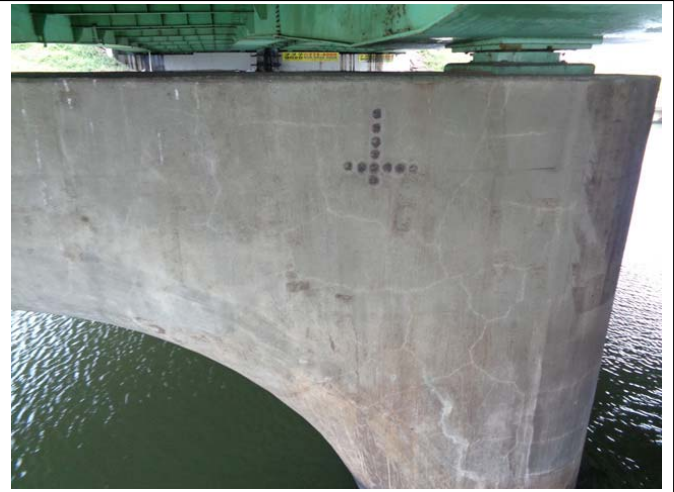
교각 포스코방향 P9 균열
