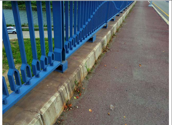
연석 운동장방향 S09 외측 균열
