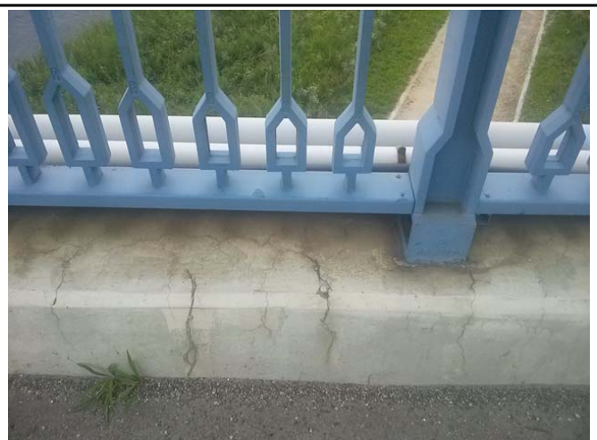
연석 포스코방향 S01 외측 망상균열
