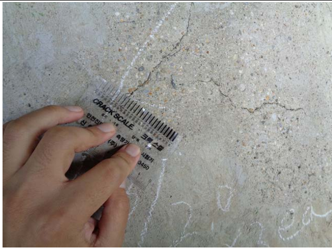
교각 포스코방향 P8 기둥부 균열
