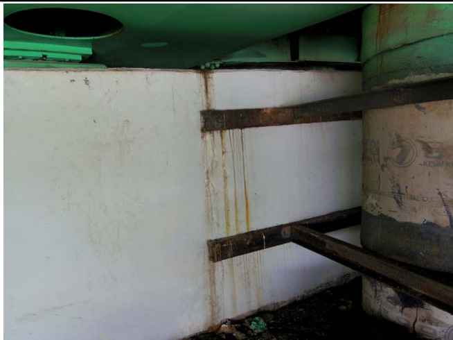
교대 운동장방향 A2 균열
