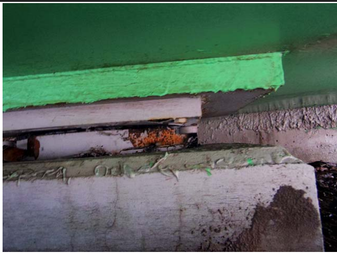
교량받침 운동장방향 A1-SH1 도장손상 및 받침콘크리트 균열
