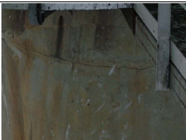
교각 운동장방향 P3 배면 균열
