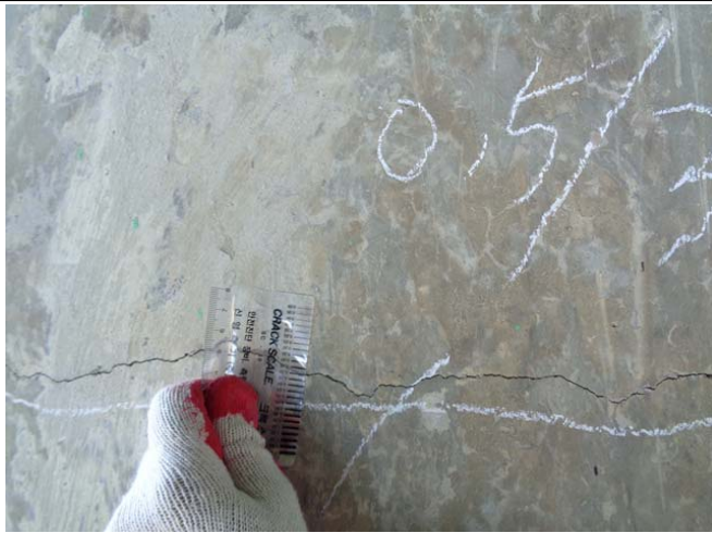
교각 운동장방향 P2 기둥부 균열
