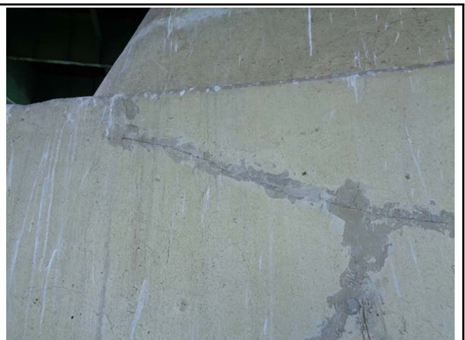
교각 운동장방향 P5 기둥부 균열
