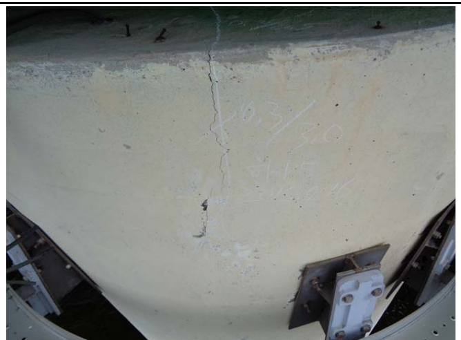
교각 운동장방향 P5 균열
